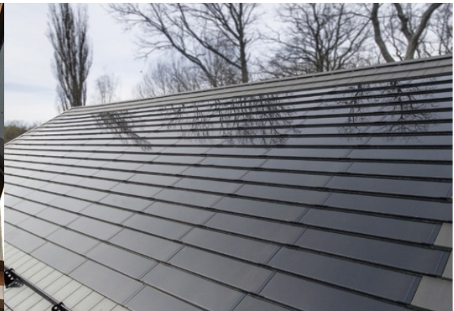
Dachintegrierte PV-Elemente - Quelle: ASP
